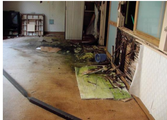
漏水により傷みが激しい溪泉亭内部
