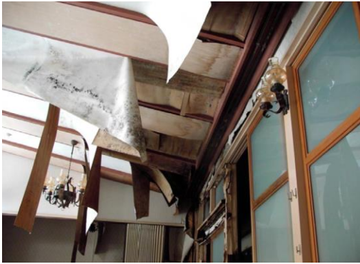
漏水により傷みが激しい溪泉亭内部
