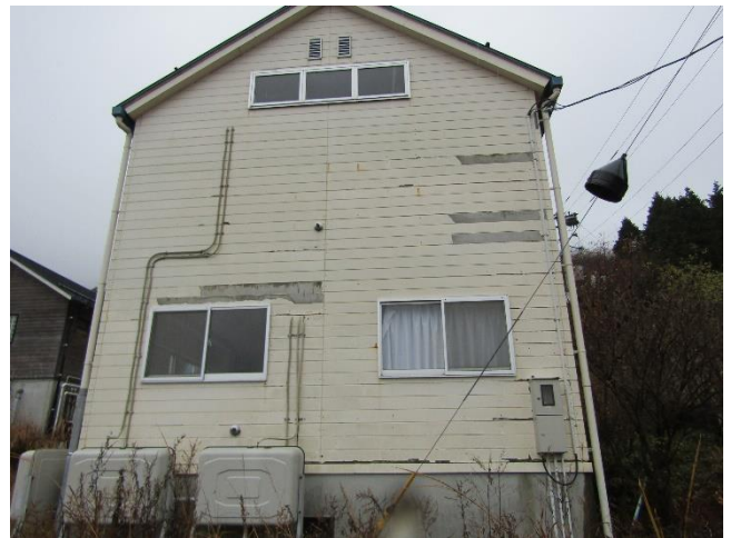
（外壁劣化 みかわ（休憩所））
