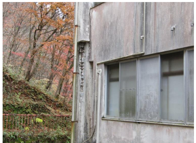
（外壁劣化 古岩屋荘外壁）
