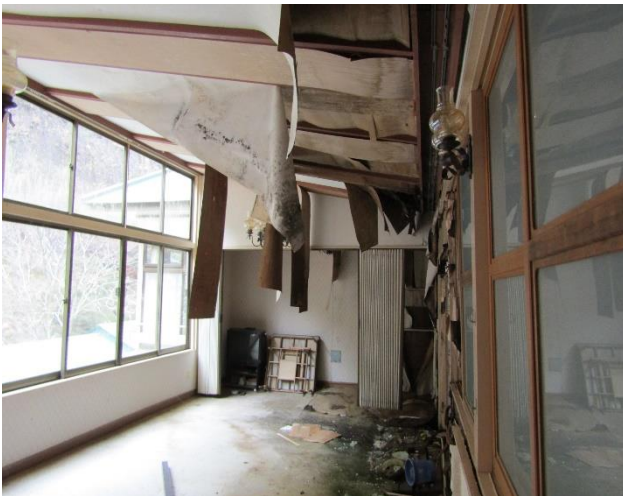
（天井劣化 溪泉亭）
