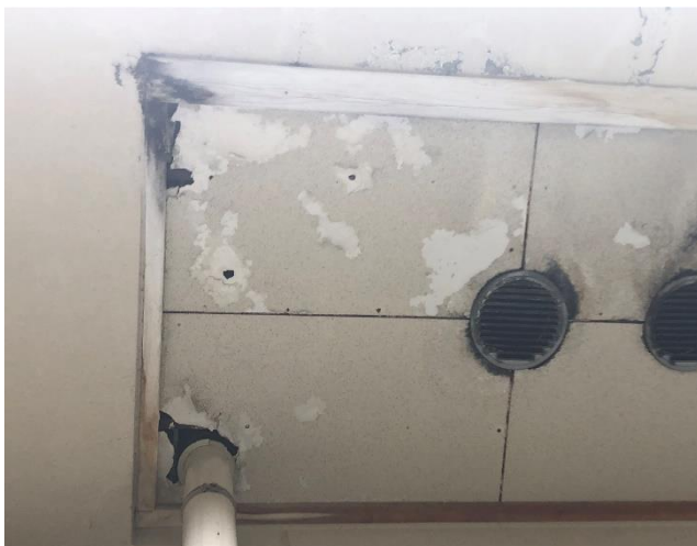
（外壁劣化 老人保健施設あけぼの）
