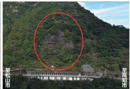
① 橋洞門上部大規模岩盤崩落危険箇所
