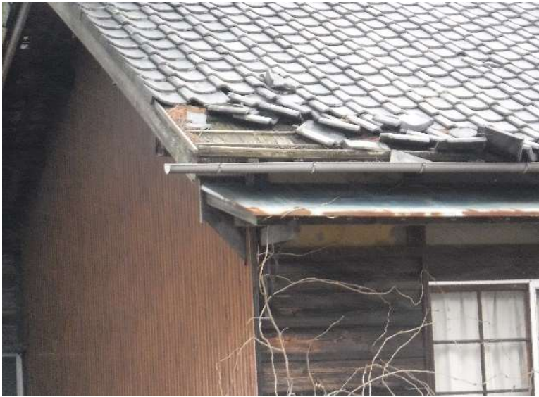
屋根破損箇所
