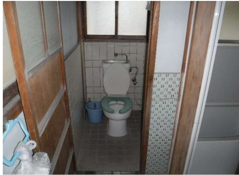
トイレ(簡易水洗)
