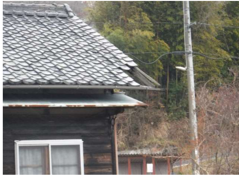
屋根破損箇所
