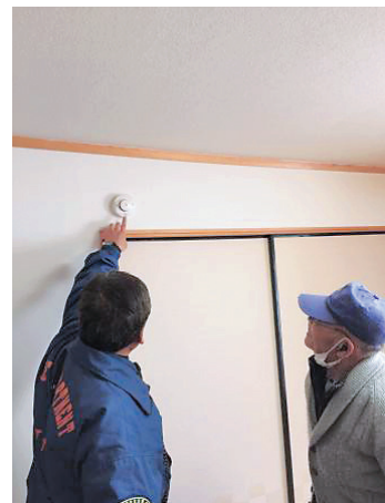
設置されている火災報知器の点検を行う消防職員
