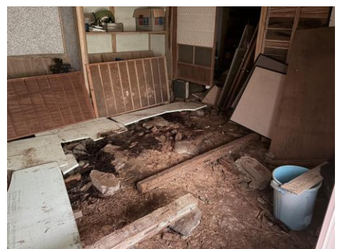
部屋⑨(床抜け)
