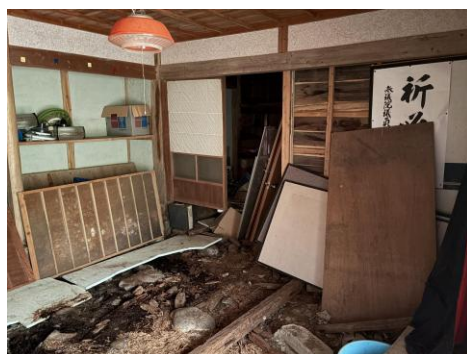
部屋⑨(床抜け)
