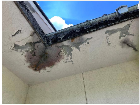
(外壁劣化 父二峰小学校教員住宅 1号)
