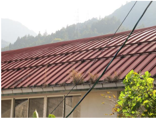
(屋根劣化 旧柳井川小学校 (体育館) ※遊休施設)
