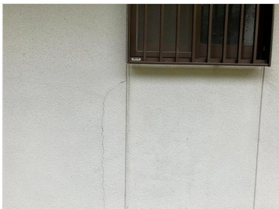
(外壁劣化 美川中学校教員住宅 10号)
