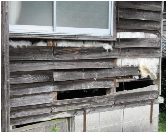
(外壁劣化 古味宿舎 (宿舎))
