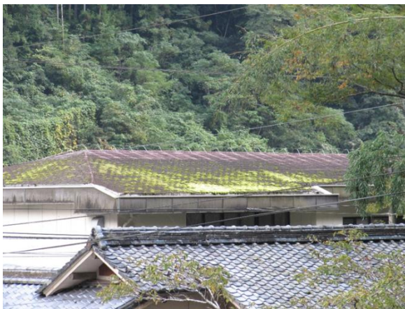
（屋根劣化 柳谷団体事務所）
