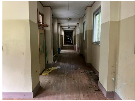
(内部劣化 旧西谷小学校 (校舎) ※遊休施設)
