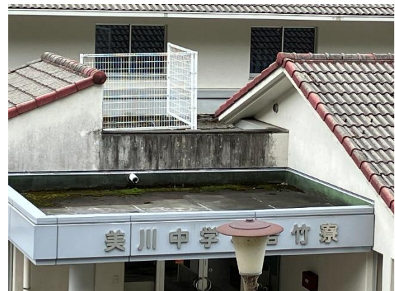
(屋根劣化 若竹寮)
