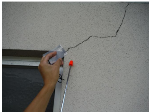
（外壁劣化 西明神高齢者創作館）
