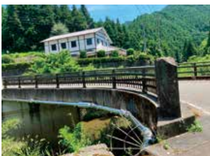
橋下のマンホールポンプと 終末処理場の遠景
