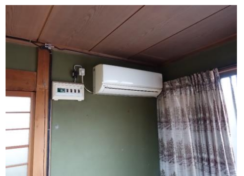
台所横和室③エアコン
