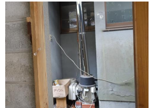
外側ボイラー
