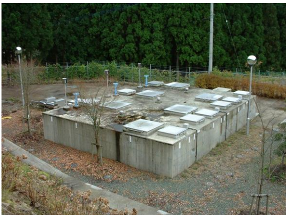
緩速ろ過池（上向性） 二名簡易水道瀬戸浄水場
