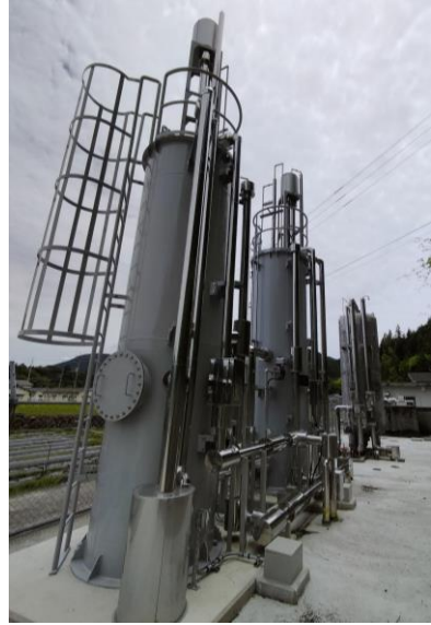
急速ろ過機（重力式） 粒状活性炭ろ過機 畑野川簡易水道千本浄水場
