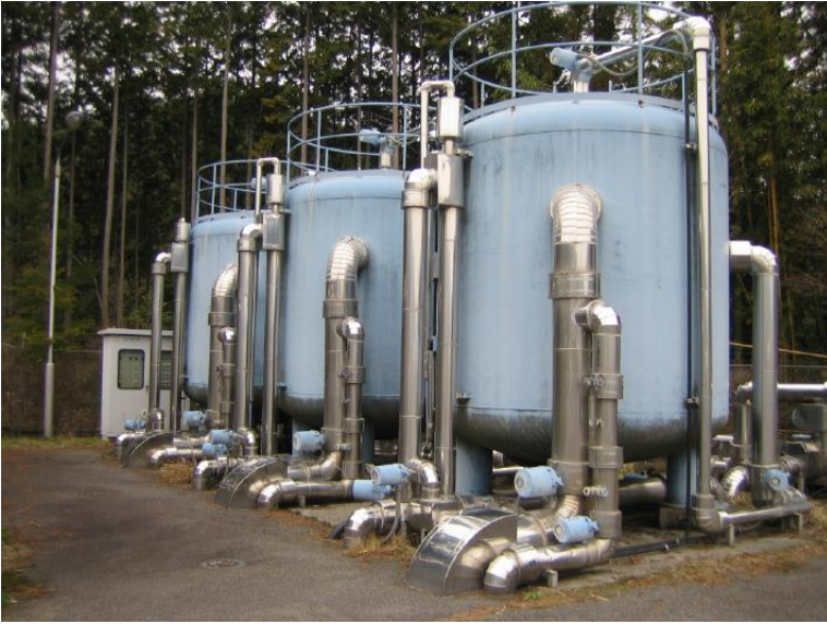
急速ろ過機（圧力式） 久万簡易水道高山浄水場
