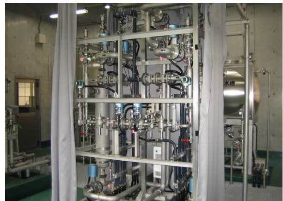
膜ろ過装置（UF膜） 直瀬簡易水道下直瀬浄水場
