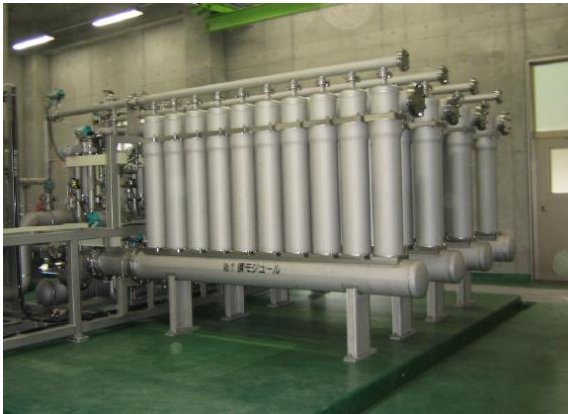
膜ろ過装置（MF膜） 久万簡易水道下野尻浄水場
