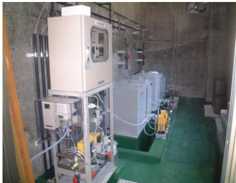
薬品注入設備 久万簡易水道下野尻浄水場
