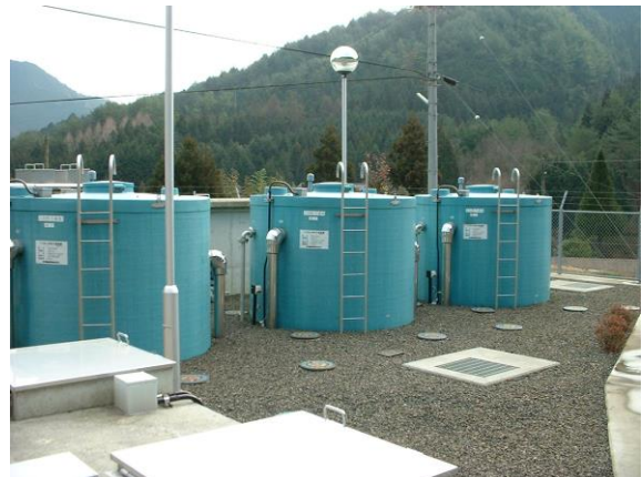
緩速ろ過池（上向性） 畑野川簡易水道中野村浄水場
