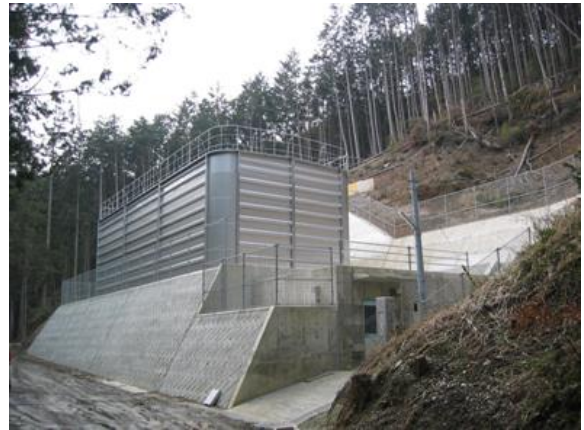
ステンレス製配水池 久万簡易水道下野尻配水池
