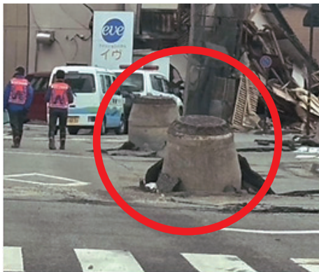
地上に浮き上がったマンホール
