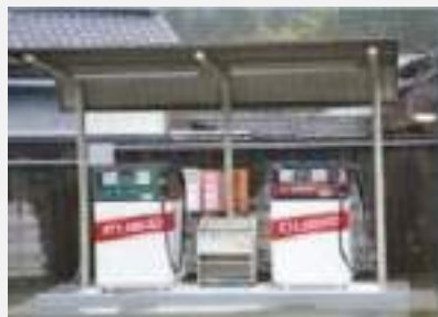
簡易計量機の設置例
