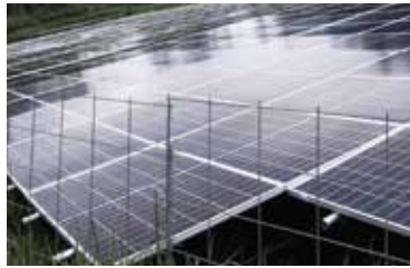
太陽光パネル
