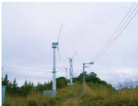
風力発電施設
