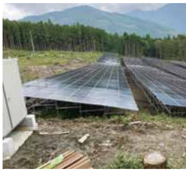
赤蔵ヶ池近くの太陽光発電施設
