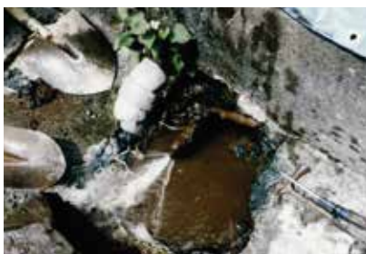
公共下水道漏水現場確認写真
