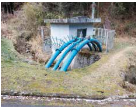
橋梁添架水道管
