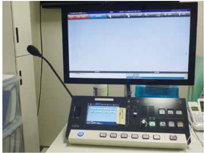
防災行政無線操作卓
