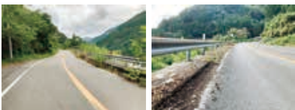
地盤沈下が止まらない旧33号線
