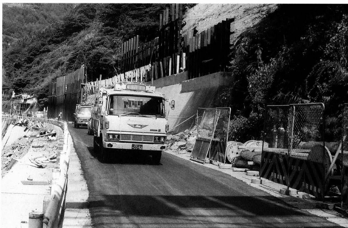
国道33号線全面通行止、8月4日片側通行可能 昭和54年7月20日
