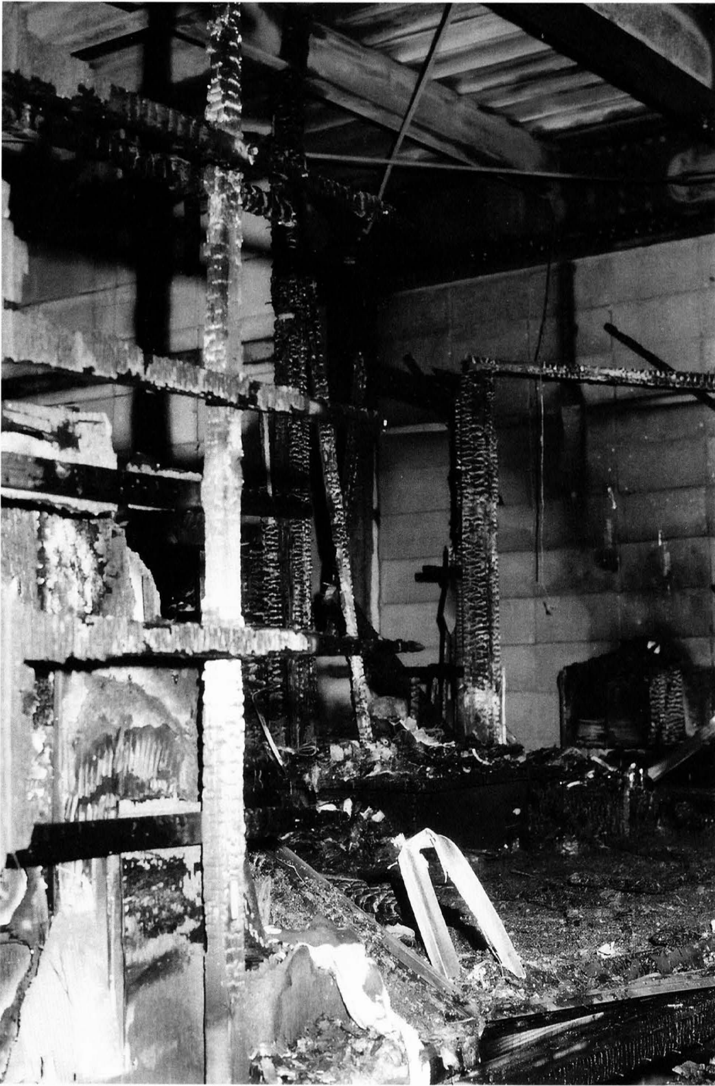
落出火災発生 昭和56年2月6日
