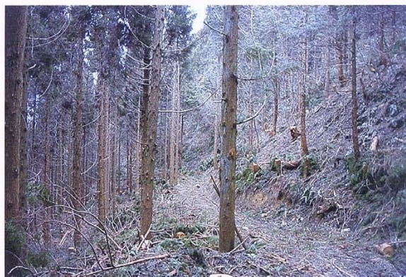
保安林整備事業で実施された本数調整伐及び 林内作業車道(大川地区)
