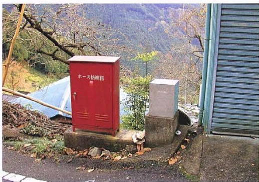
消火栓釣井地区
