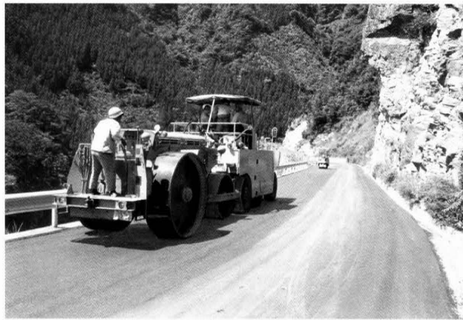
舗装工事の始まった石鎚スカイライン(面河村関門のスカイライン入り口付近で)
