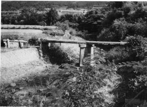
施工前 老朽化した木橋
