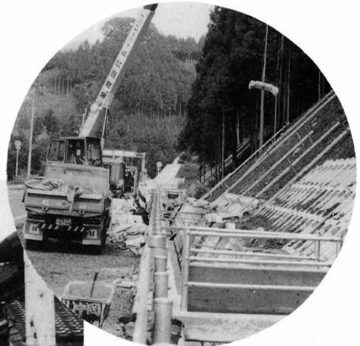
急がれる防災工事 三坂峠附近
