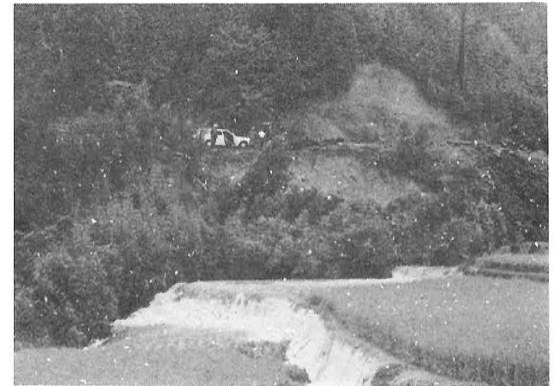
東明神本組林道被害状況
