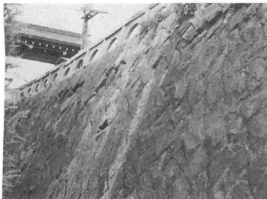
町道大坊線（総門）復旧前
