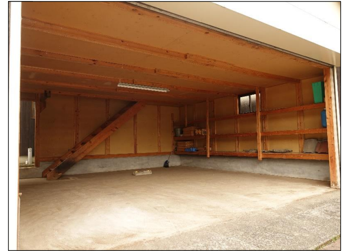
倉庫(シャッター電動)
