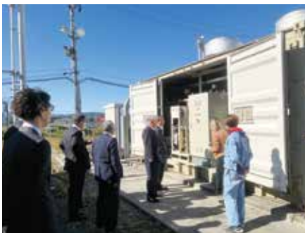
相馬市・水素の生成と燃料電池での発電設備
